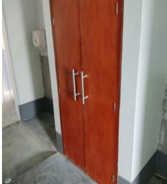
INSTALACIÓN DE PUERTA DE MADERA PARA EL DEPÓSITO DEL ÁREA DE DESINFECCIÓN.
